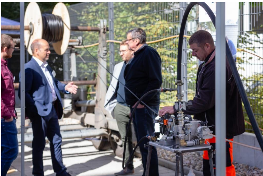
Die Firma Rhön-Montage Fernmeldebau GmbH zeigte den Workshop-Teilnehmern wie die Glasfaserkabel von LAPP eingblasen werden.
